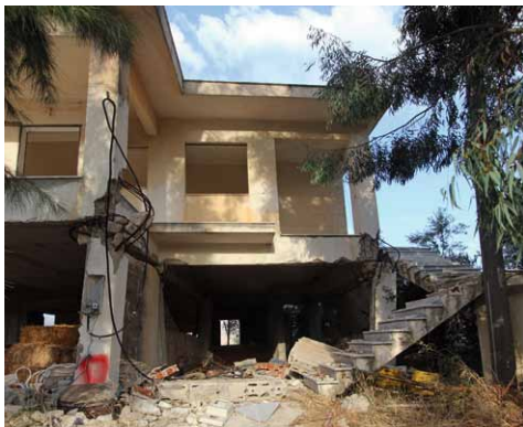
Schade als gevolg van de beving van 2014 bij Lixouri
